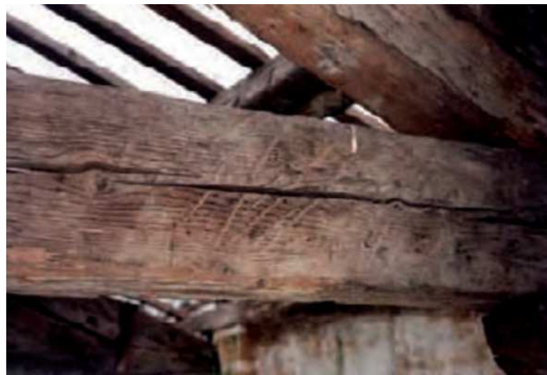
Fonte: «Le fessure nel legno massiccio: fisiologiche o patologiche?», Franco Laner, www.agostinilegnami.com
